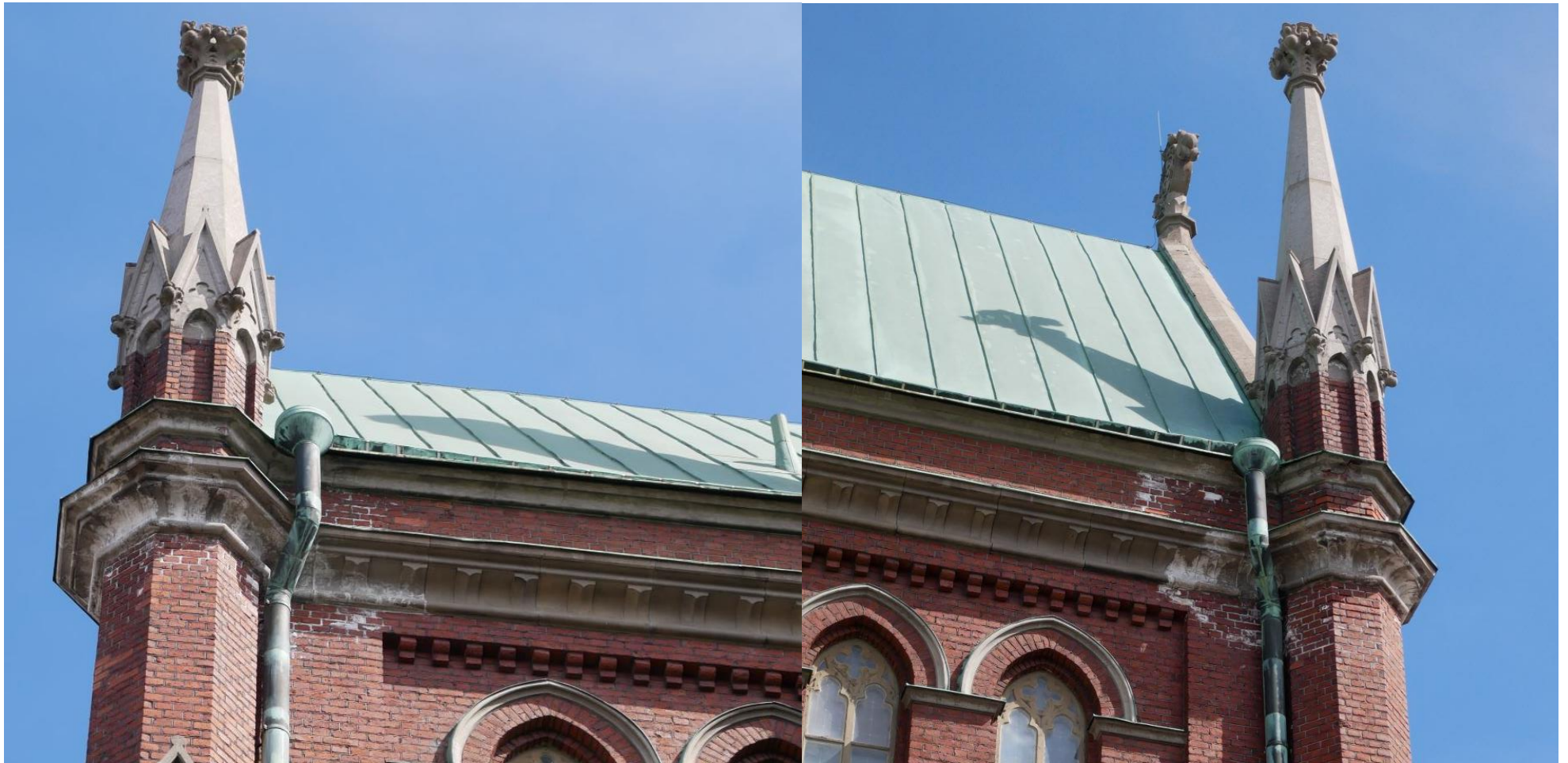
Kuva 10 ja Kuva 11. Kalkkihärmettä betoni- ja tiilipinnoilla poikkilaivojen vesikaton päädyissä syöksytorven ympäristössä.
